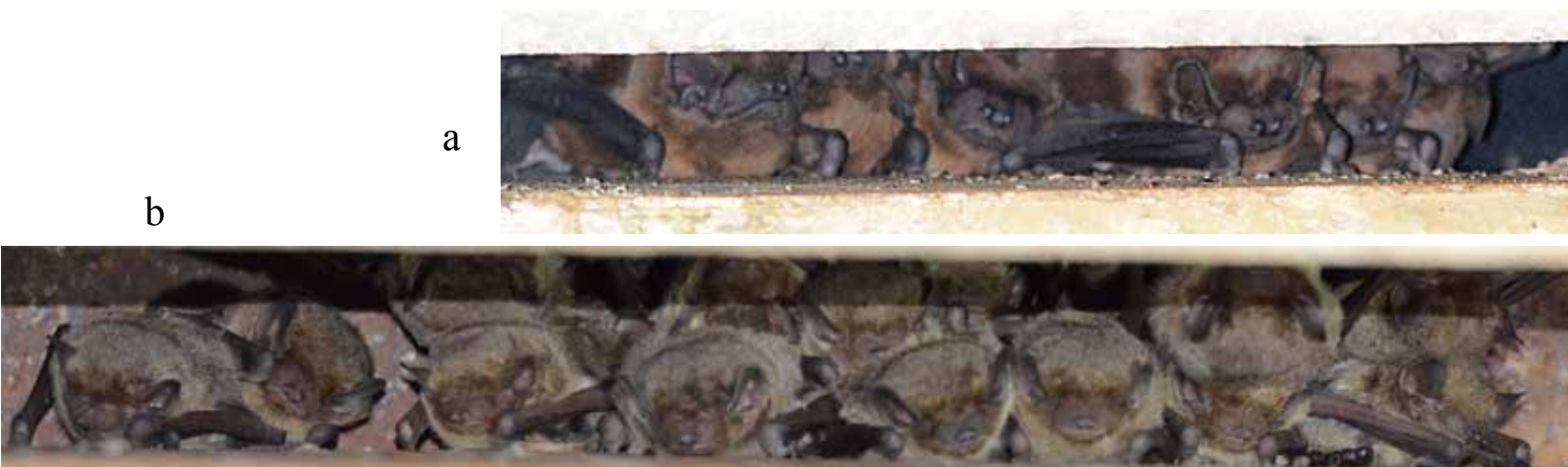
図2 井原鉄道高架の橋梁間の継ぎ目にてできた隙間にいたコウモリの確認状況。a: ヤマコウモリ(2016年11月10日)。b: アブラコウモリ(同4月18日)。
