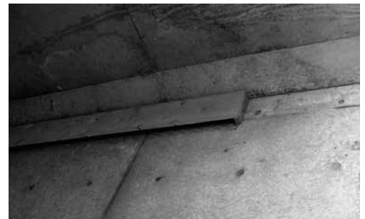
写真3 木板のバットボックス
